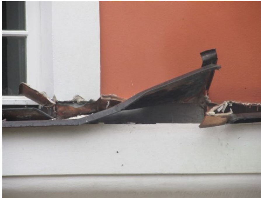
Dachschaden am Vordach der Bucher Schlosskirche – Foto: C.Reuter
