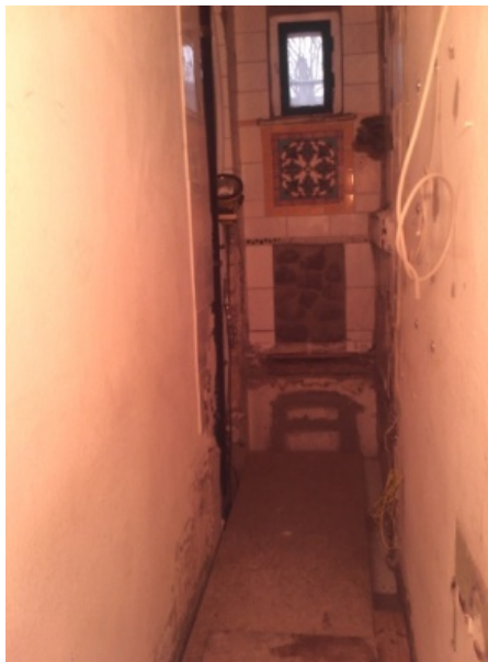
Altbau-Badezimmer – aktueller Zustand: unbewohnbar trotz behördlicher und gerichtlicher Verfügungen
