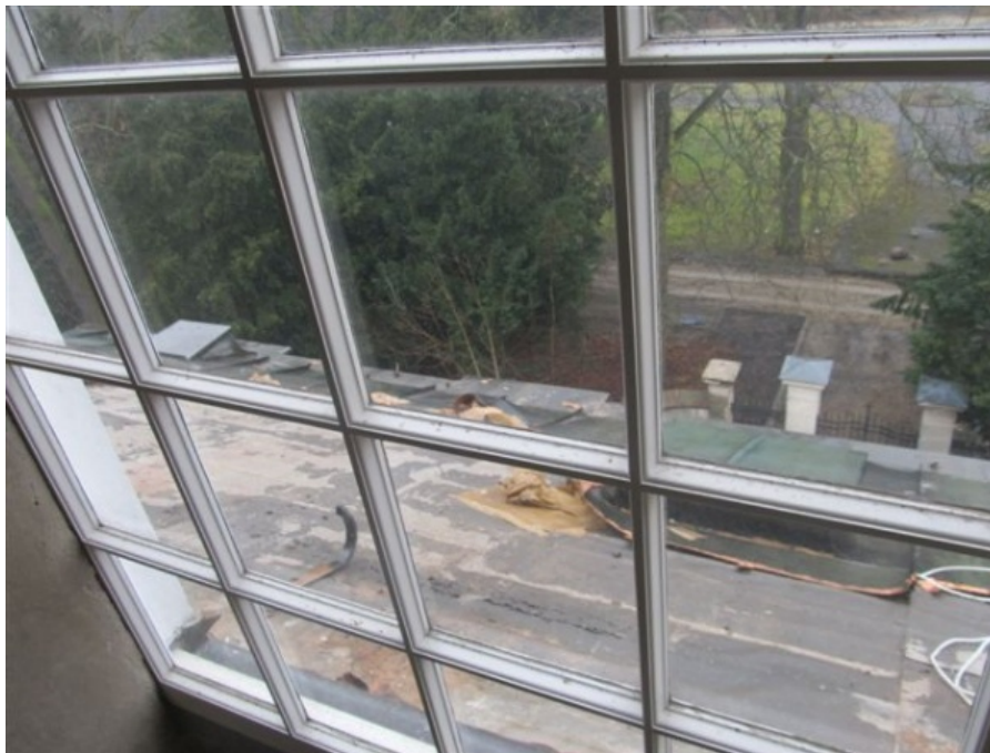
Dachschaden am Vordach der Bucher Schlosskirche im März 2014 – Foto: C.Reuter
