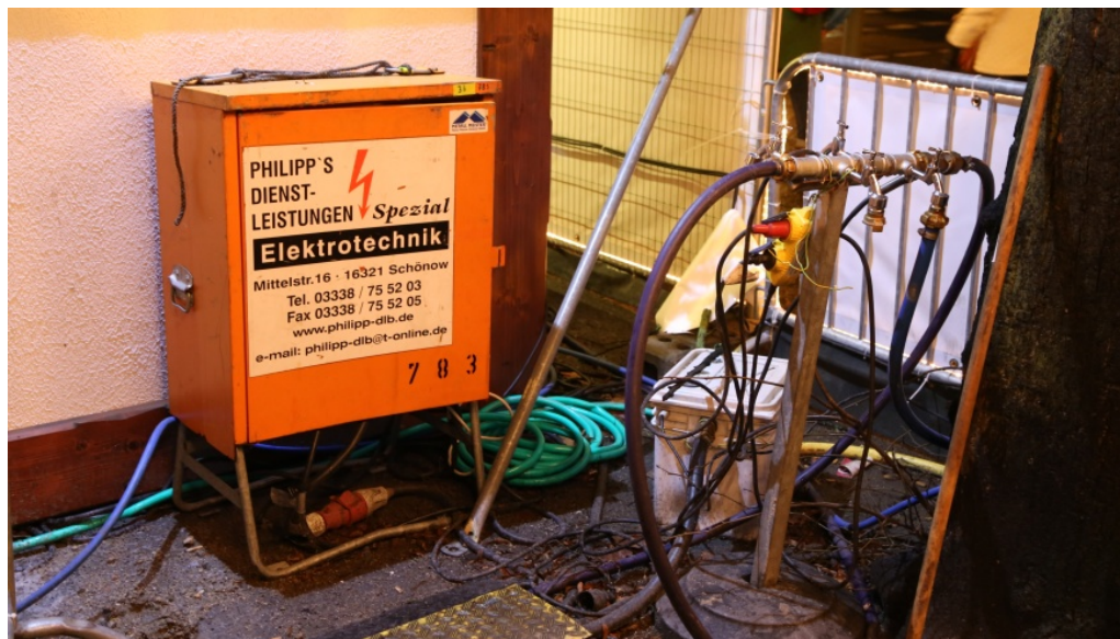
Kostentreiber bei Stadtfesten: Baustrom & Wasser – Foto: m/s
