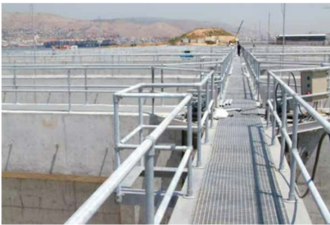
Barierki na oczyszczalni ścieków - złącza Kee Klamp
