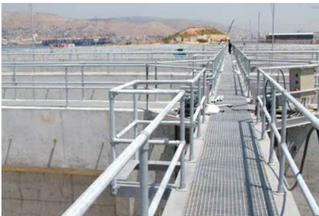
Barierki na oczyszczalni ścieków - złącza Kee Klamp
