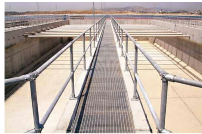
Barierki na oczyszczalni ścieków - złącza Kee Klamp
