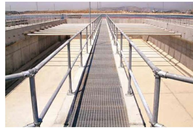
Barierki na oczyszczalni ścieków - złącza Kee Klamp
