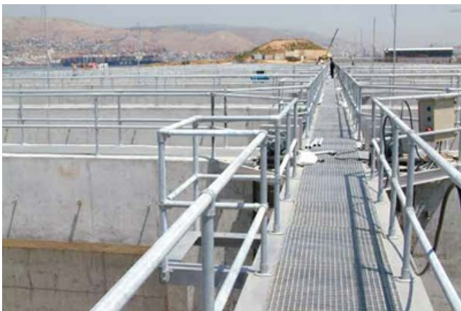
Barierki na oczyszczalni ścieków - złącza Kee Klamp
