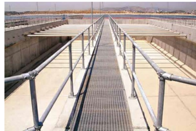
Barierki na oczyszczalni ścieków - złącza Kee Klamp
