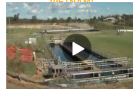
TRẠM XỬ LÝ NƯỚC THẢI NHÀ MÁY CHẾ BIẾN TINH BỘT SẮN (CAMIX VIETNAM)
